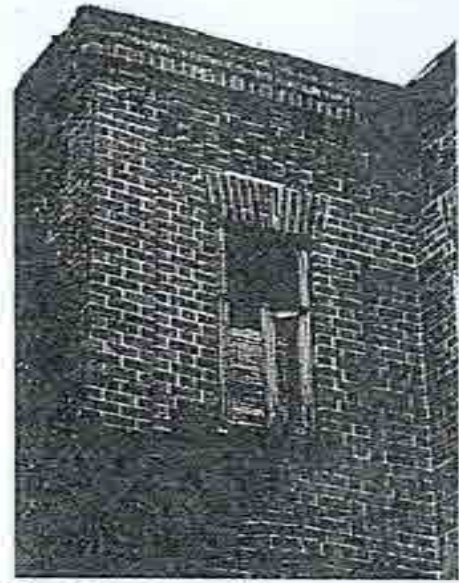
Фото 3. Вид с северо-запада. Фрагмент дворового фасада. Трещины, деформация окна, отсутствие остекления.
